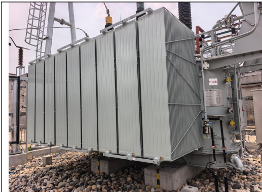
1 号主变及油坑
