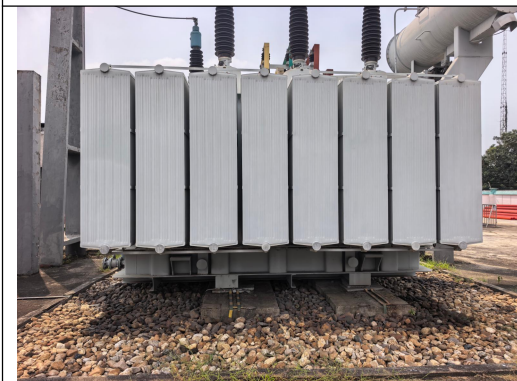
2 号主变及油坑
