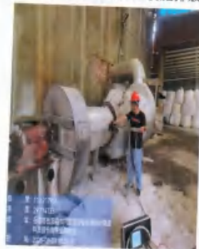
燃烧烟气排放口
