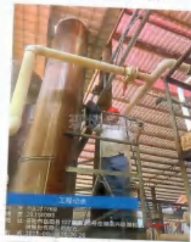
DA002 干燥废气排放口
