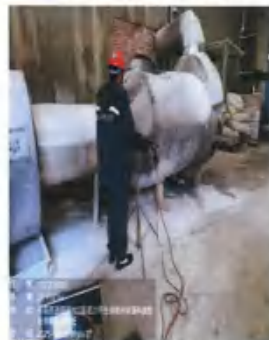
燃烧烟气排放口
