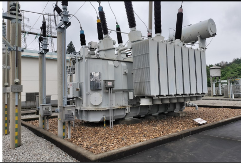
1 号主变及油坑
