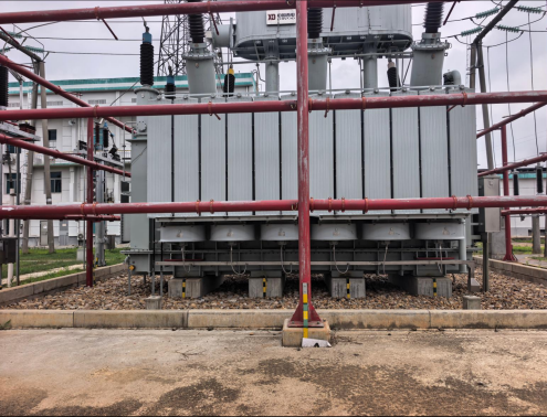
2 号主变及油坑
