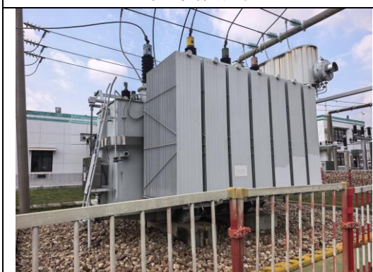
2 号主变及油坑
