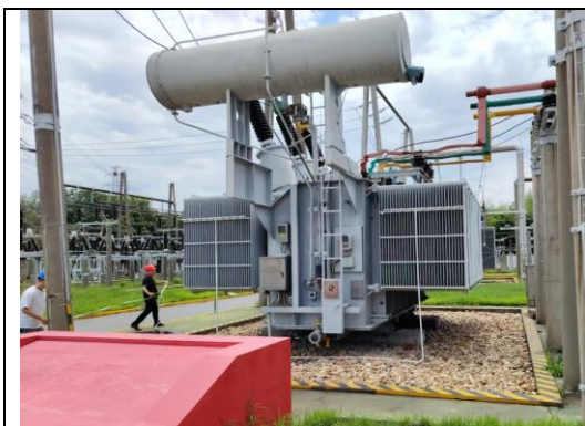
1 号主变及油坑
