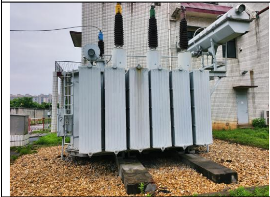
2 号主变及油坑
