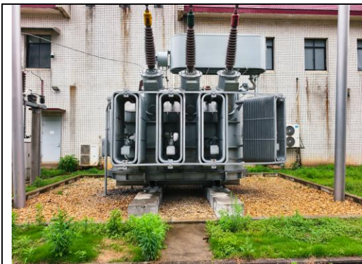
1 号主变及油坑
