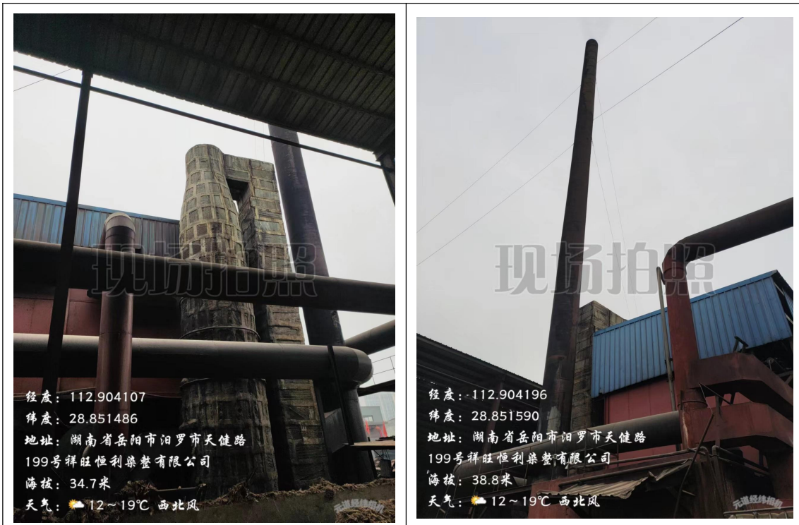
现有废气处理措施及排气筒
