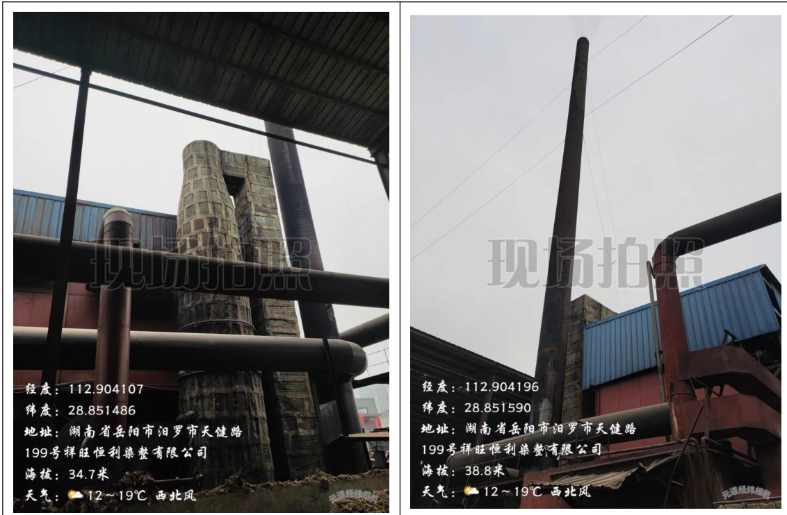
现有废气处理措施及排气筒
