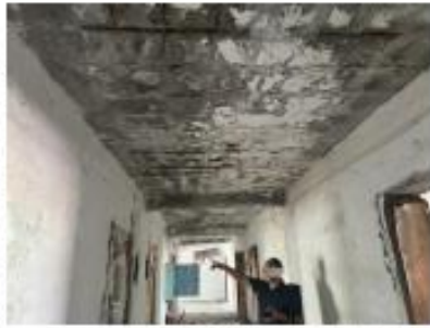
经过存在不同程度的水泥脱落情况 魏耀 摄
