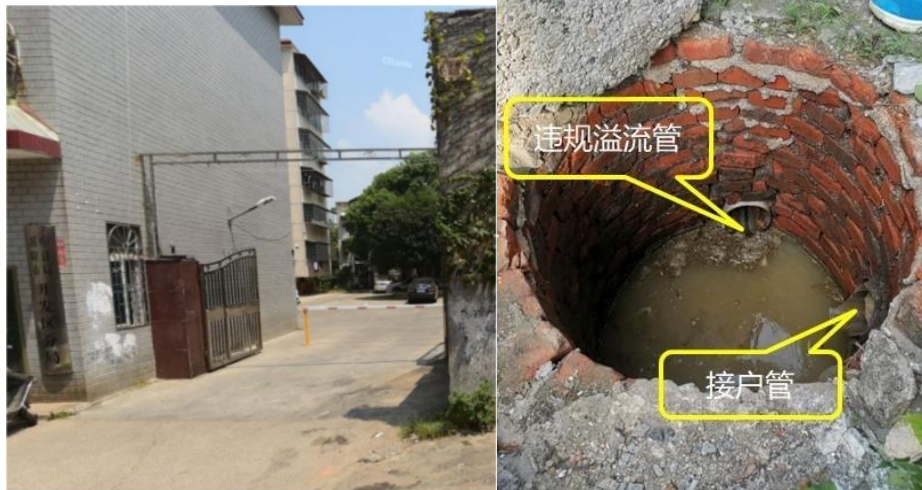
岳阳市审计局开发区分局现状图、金湖小区排水检查井淤堵图
