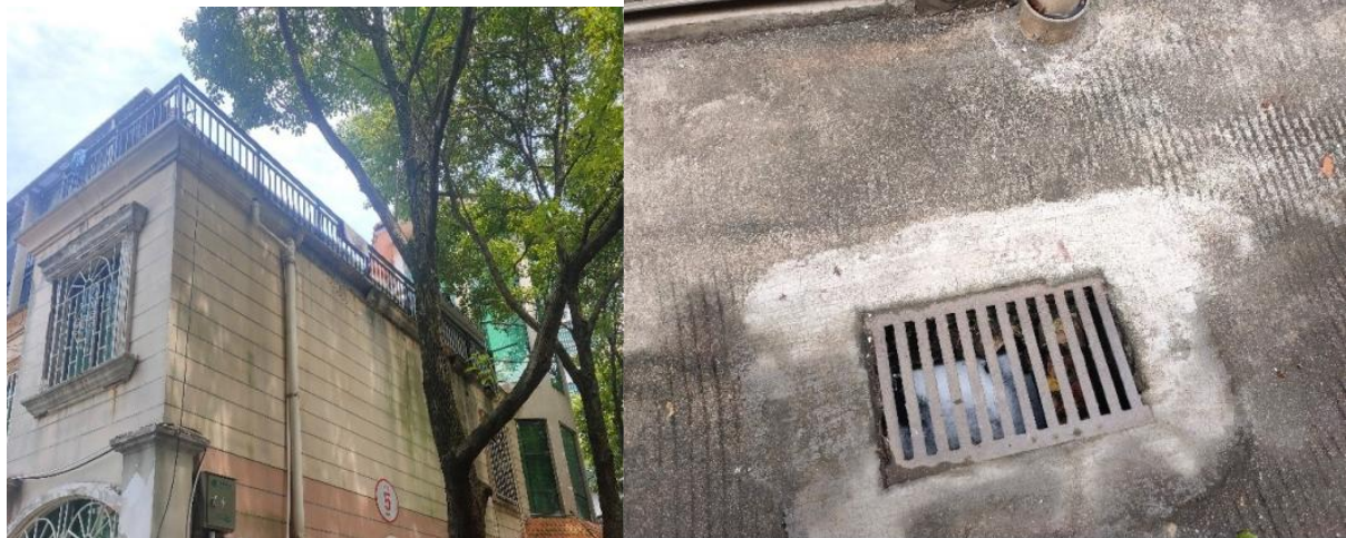
湖畔新村小区现场照片（洗衣机水混接进入雨水立管、生活污水接入雨水篦子）
