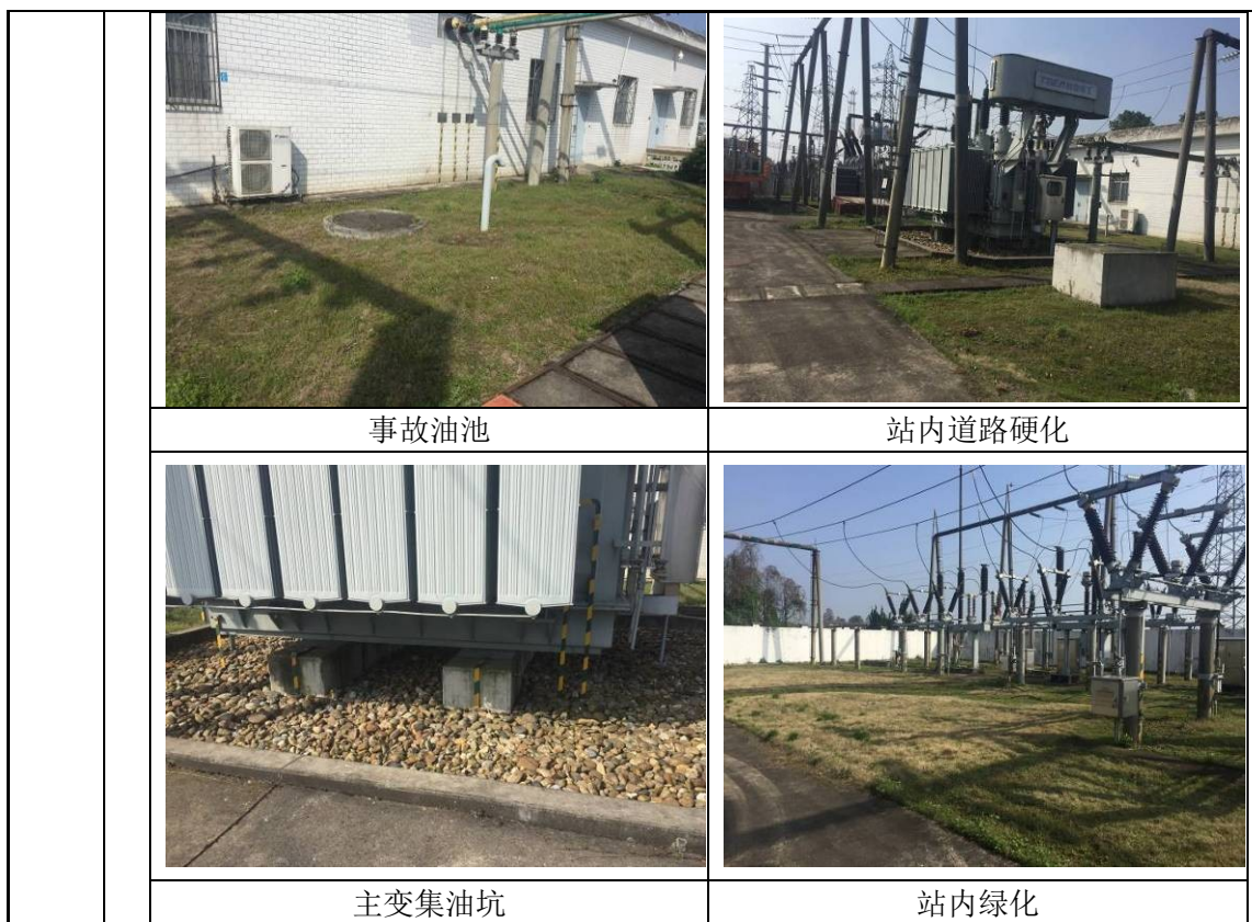
图 2-3 泉新 110kV 变电站环保设施
