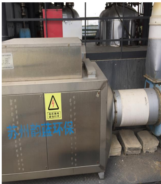
废气处理装置
