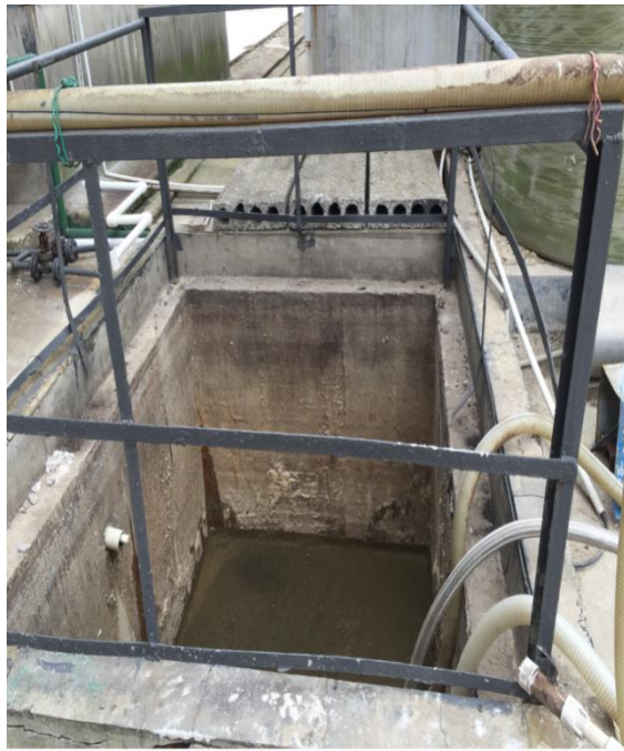
废水收集处理池
