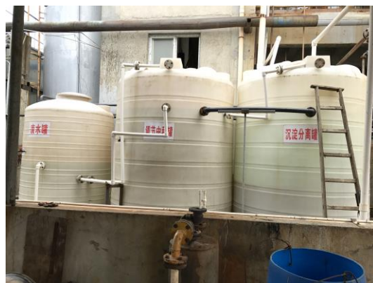
污水处理设施
