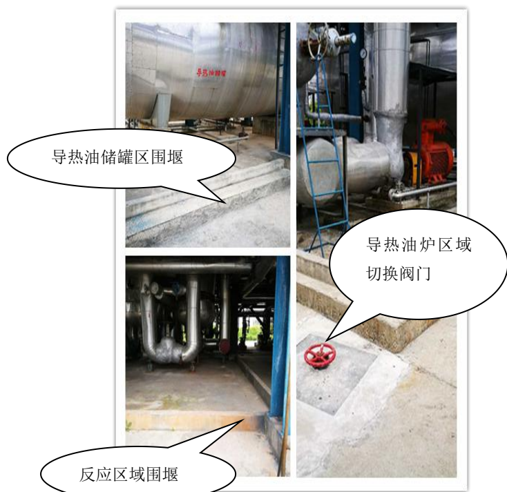
图 3.7 反应器和炉区围堰、切换阀门
