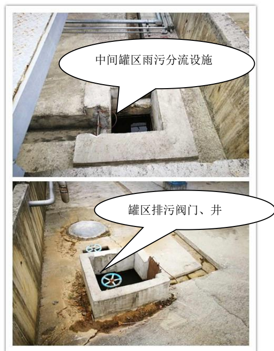
图 3.6 罐区排污阀门、井
