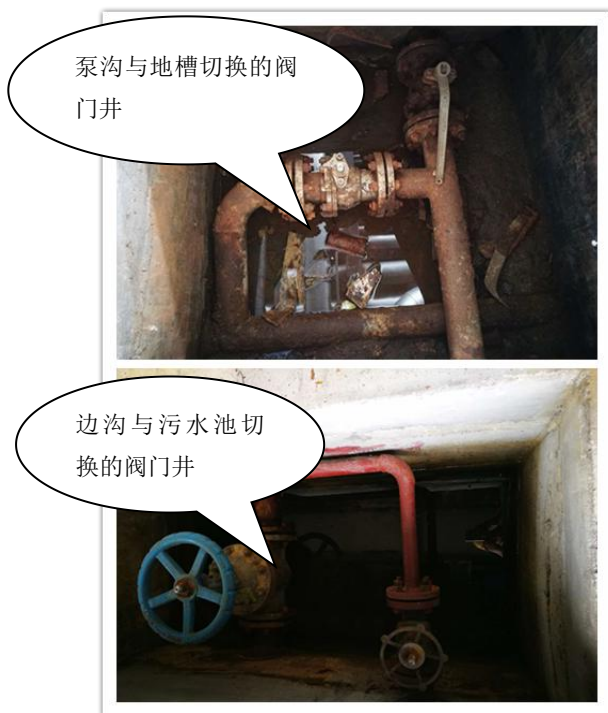
图 3.5 地下管网切换阀井
