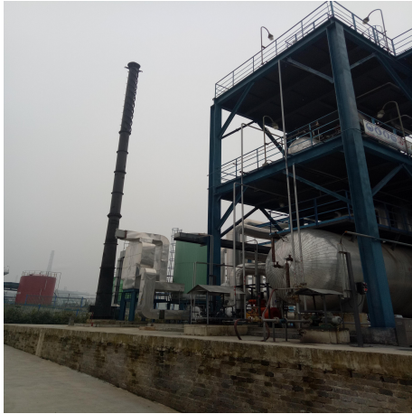
热媒炉排气筒
