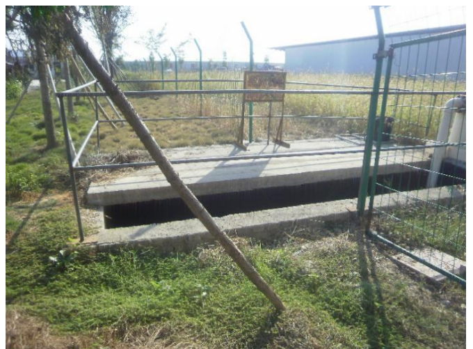
初期雨水收集池
