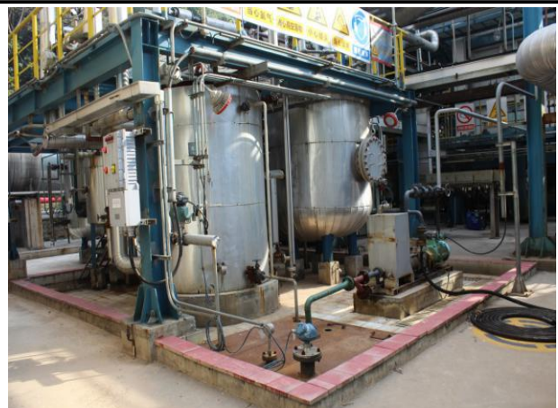
本项目液氨装置区
