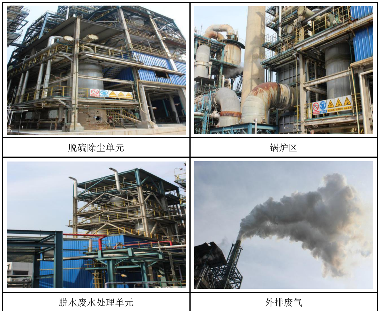
图 3-10 废气部分处置设施
