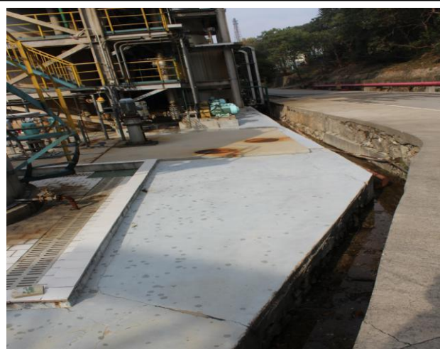
地面冲洗水收集沟（进含油系统）
