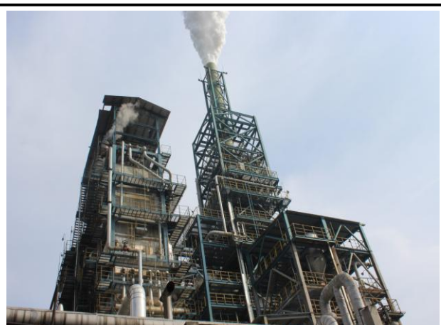
脱硫脱硝除尘设备
