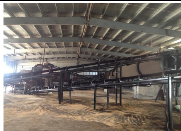
⑦号有机无机复混肥生产车间
