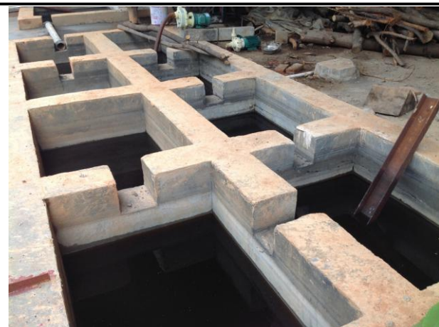
麻石水膜除尘水循环池
