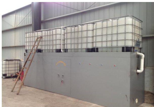
高压喷雾除臭设备
