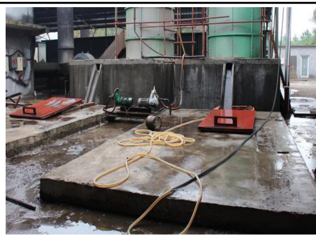
除尘喷淋循环水池
