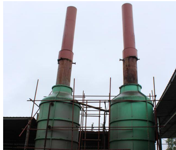
除尘水喷淋塔
