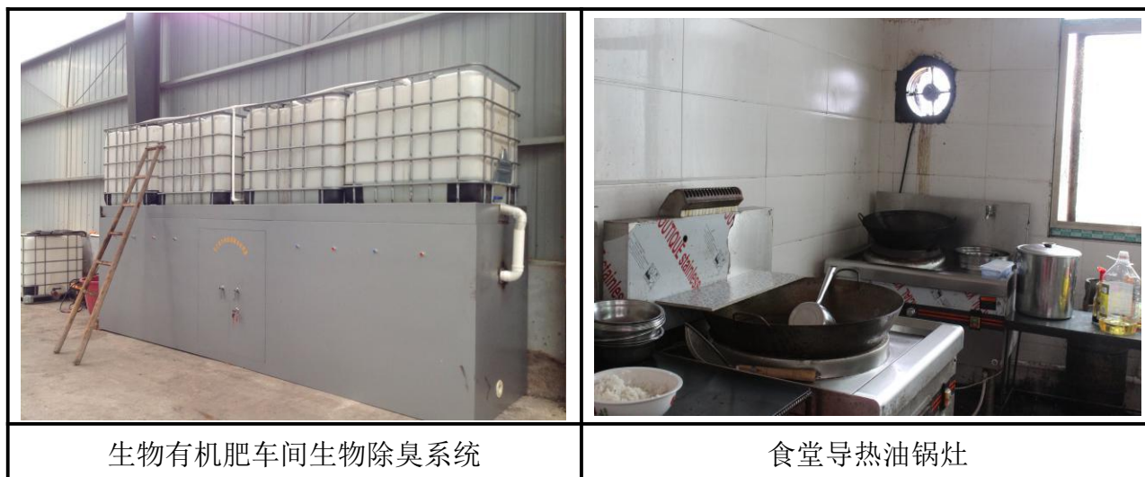
图 3-7 项目废气部分处置设施
