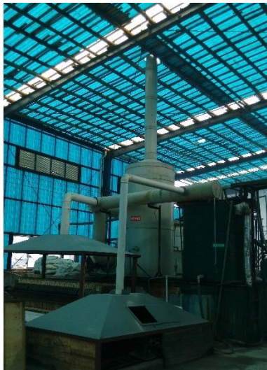
(3#) 酸溶车间（压滤机）废气处理系统
