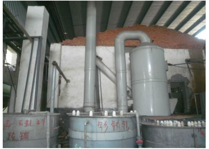
(8#) 沉淀车间废气处理系统
