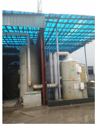
(2#) 酸溶车间（钕铁硼）废气处理系统
