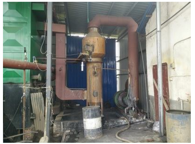
(12#) 导热油炉废气处理系统
