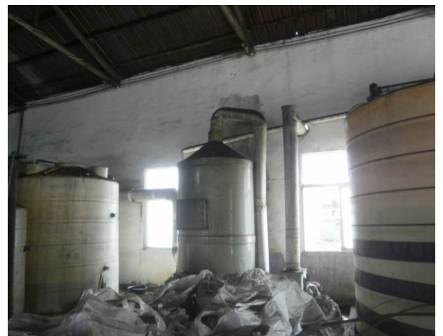
(14#) 碱煮车间酸溶废气处理系统
