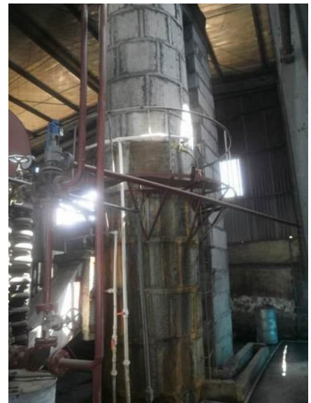
(9#) 锅炉 (4T) 废气处理系统
