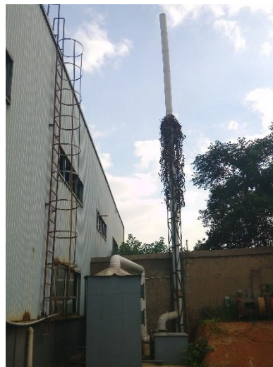
(6#) 萃取一车间萃取废气处理系统
