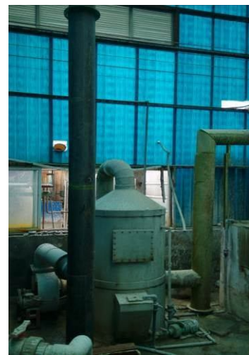
(4#) 碱溶荧光粉废气及脱氨塔废气处理系统
