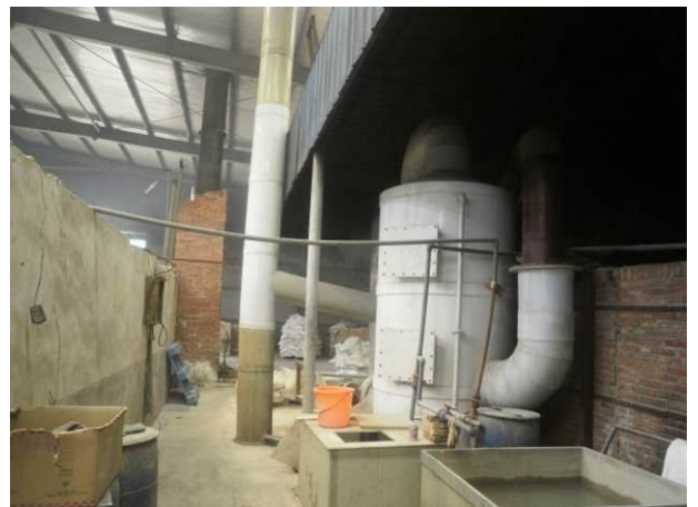
(10#) 窑炉 (大窑) 废气处理系统
