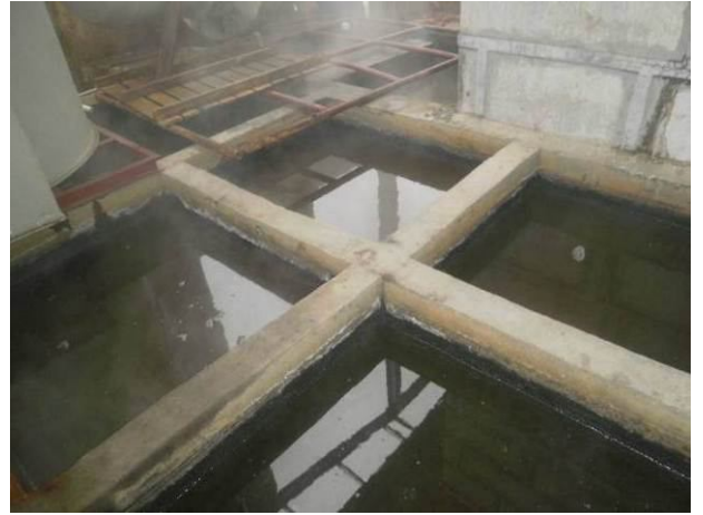
(11#) 焙烧窑炉（小窑）喷淋水循环池
