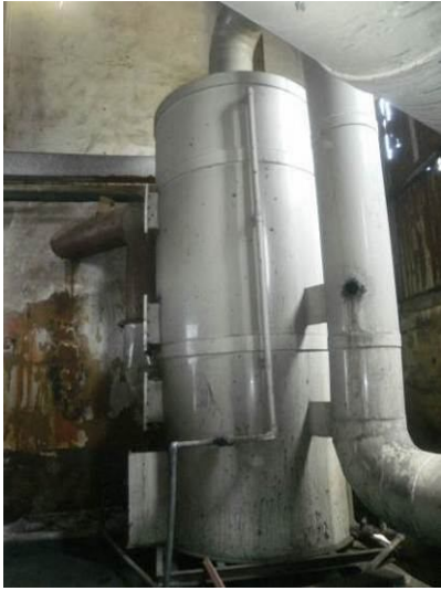
(11#) 焙烧窑炉（小窑）废气处理系统
