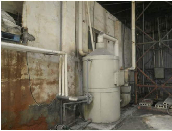
(7#) 萃取二车间酸雾废气处理系统
