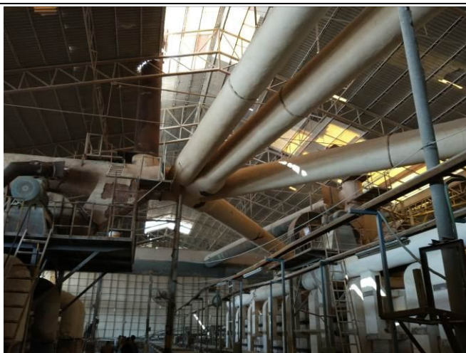
烧成窑炉余热回用管道
