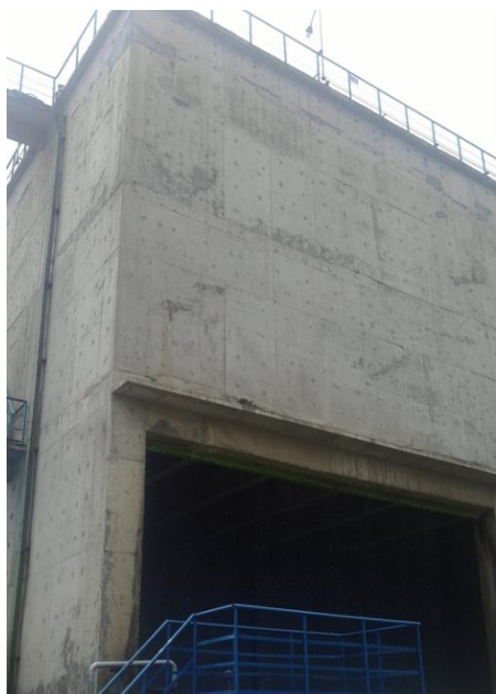
冷却循环水池
