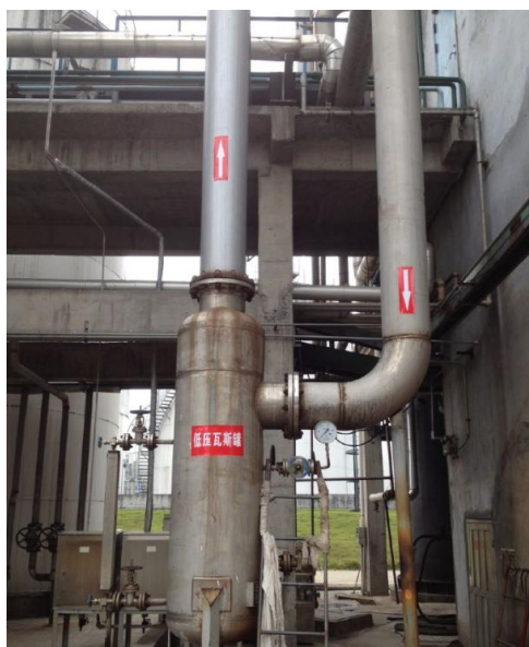
低压瓦斯系统（送至长炼焚烧装置）
