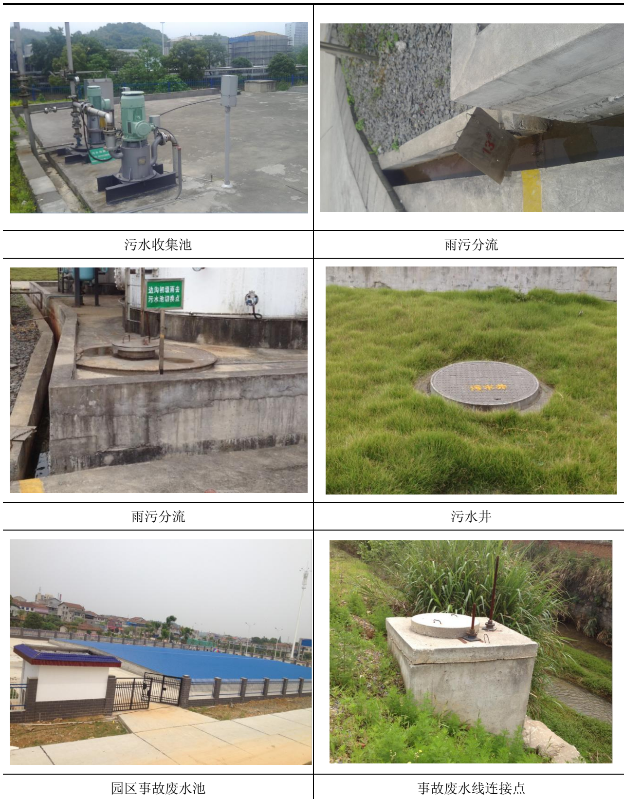
图 3-6 废水处理设施
