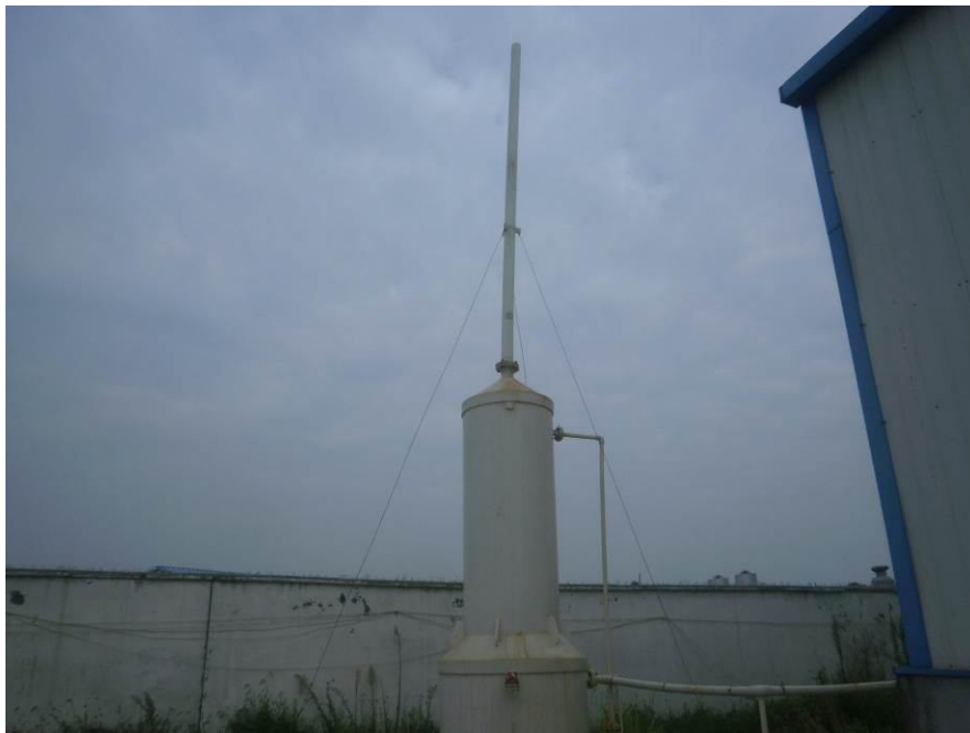
图3-11 废气处理装置
