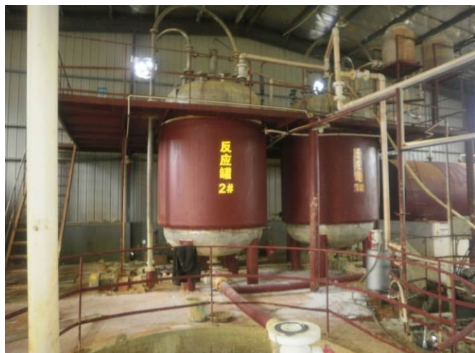
生产装置（反应罐）
