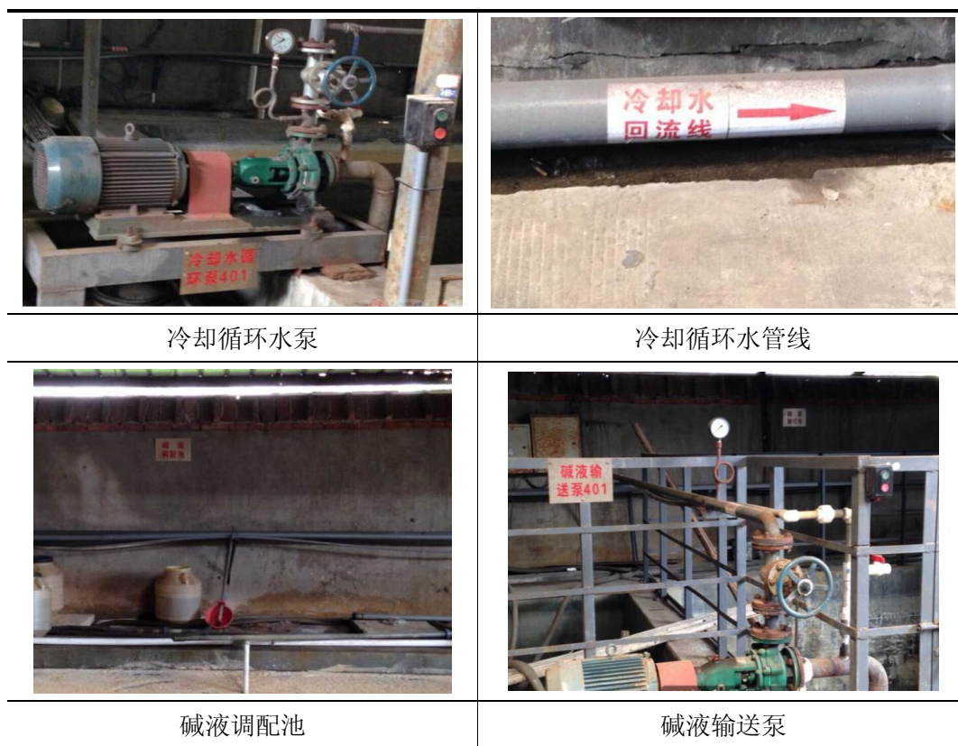
图3-5 碱液调配池、各类管线
