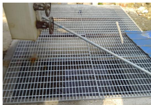
初期雨水收集池
