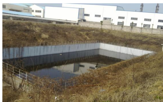
工业园区事故废水应急池
