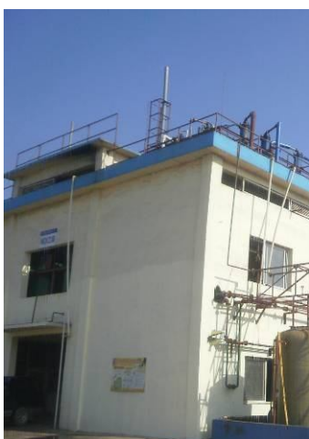
二(三氯甲基)碳酸酯合成尾气排气筒
