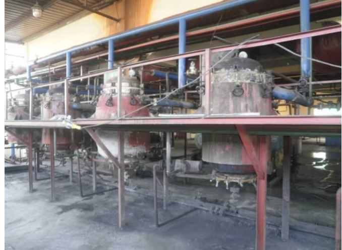
活性炭过滤装置
