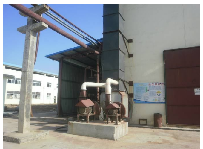
切片废气排气筒
