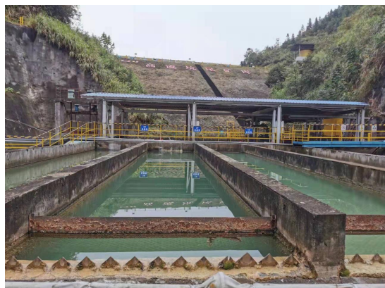
高流坑尾矿库废水处理站
