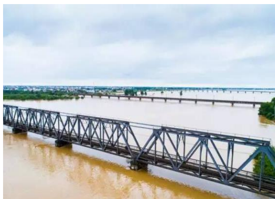
图 3.1-1 京广线铁路桥桥墩被淹
